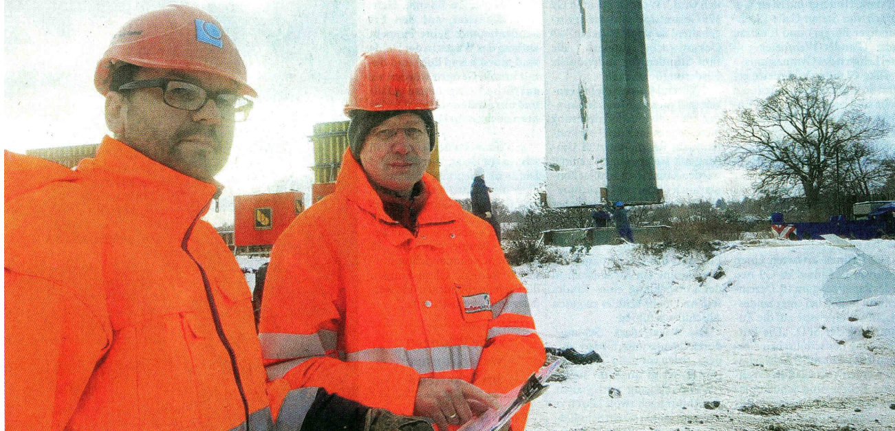
Sicherheit geht vor: Jens Oertel (Bauüberwachung Lavis, v. l.) und Arnd Graeper (Projektleiter Straßen NRW) gehen nur mit Schutzhelm auf die Baustelle der westlichen Werrebrücke. Dort justieren Stahlarbeiter gerade die rund 35 Tonnen schwere Mittel-Pylone im Hintergrund. FOTOS: SUSANNE BARTH
