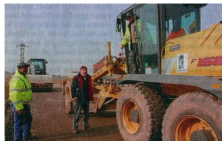
Lagebesprechung: Viktor Puschkaschow (v. l.) führt die Walze, Detlef Schubert den Bagger und Michael Münnickel den Grader.
