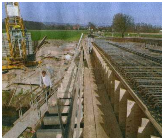
Die erste Brücke wächst: An der Wöhrener Straße arbeiten die Handwerker an Schalung und Stahl-Armierung.
